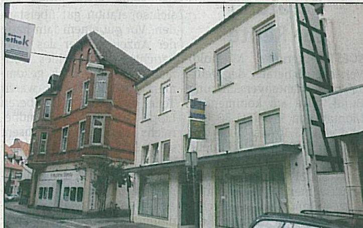
Das Haus Grandweg 4 (helle Farbe) wird abgerissen und durch einen Neubau ersetzt. ■ Fotos: Fischer
